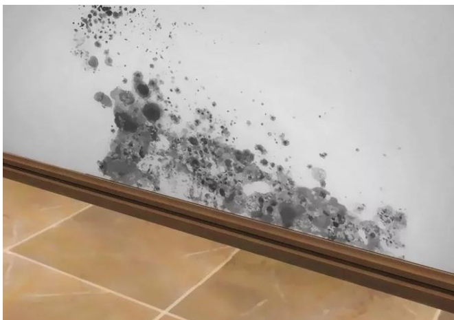
Skimmelsvamp angreb – Kældervæg med indtrængende grundfugt.
