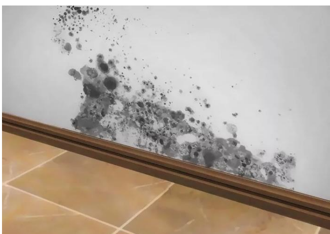
Skimmelsvampeangreb – Kældervæg med indtrængende grundfugt.
