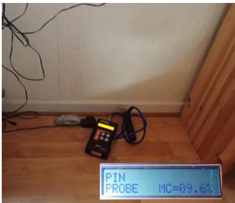
Foto nr. 10 Værelse fugtmåling i fodpanel mod ydervæg.
