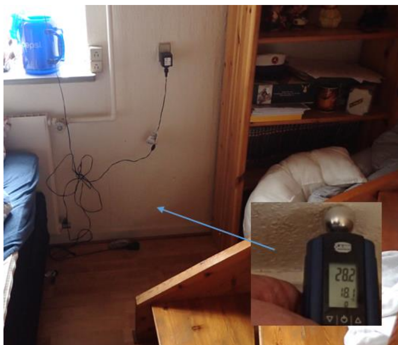
Foto nr. 09 Værelse. Fugtmåling på ydervæg.
