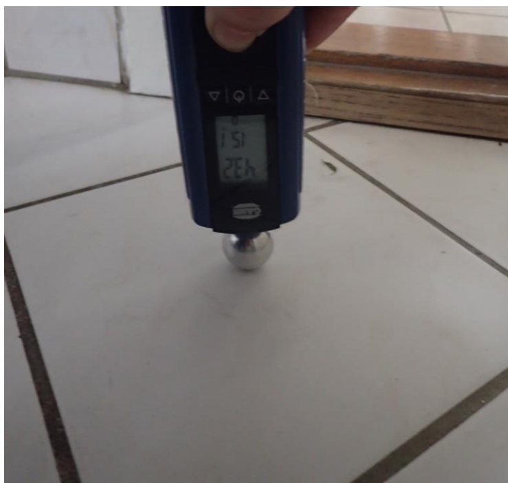
Foto nr. 17 Badeværelse. Fugtmåling mod indgang.
